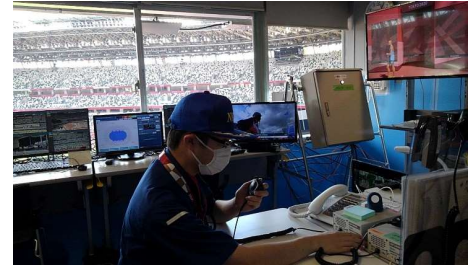
無線機の設置を行っている様子 (オリンピックスタジアム)
