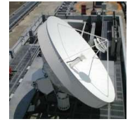
衛星固定設備
